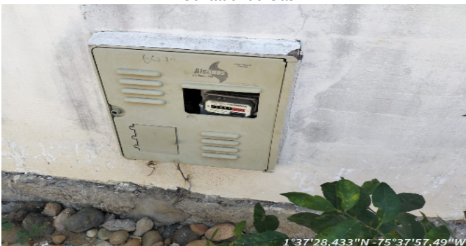
Contador de Gas
