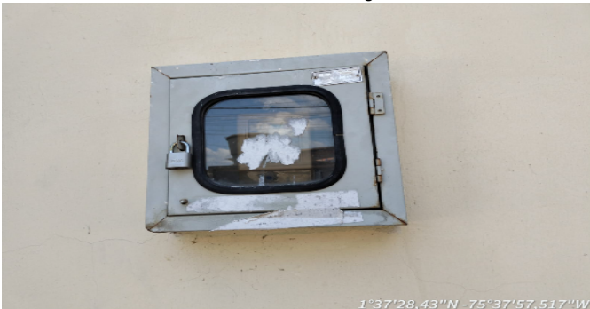
Contador de Energia
