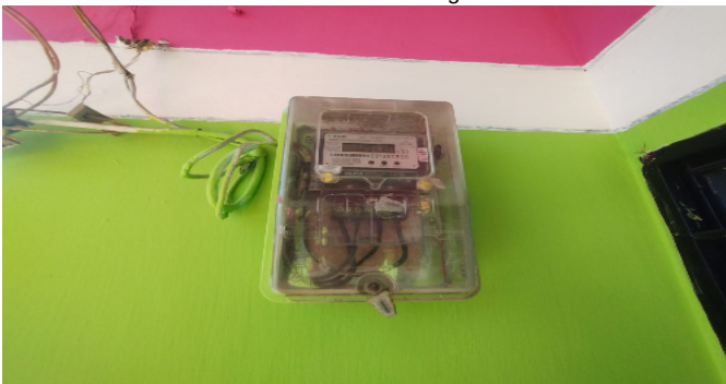
Contador de Energia
