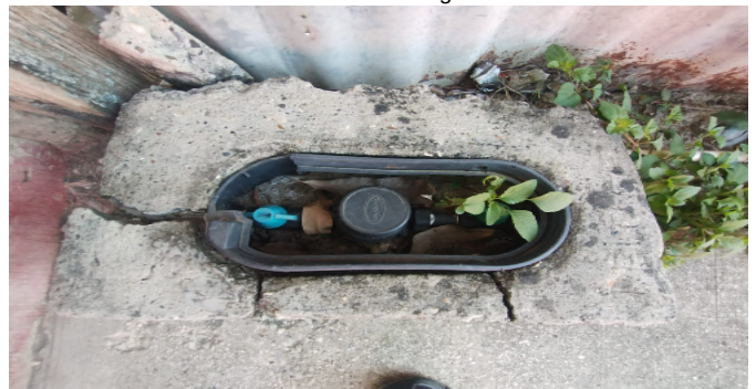
Contador de Agua
