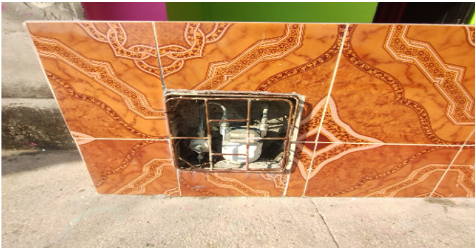
Contador de Gas
