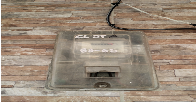
Contador de Energia
