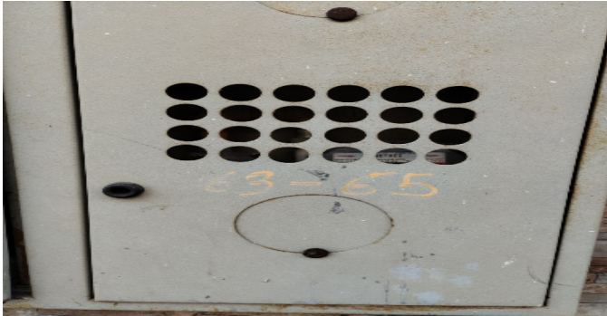
Contador de Gas
