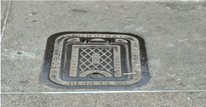
Contador de Agua
