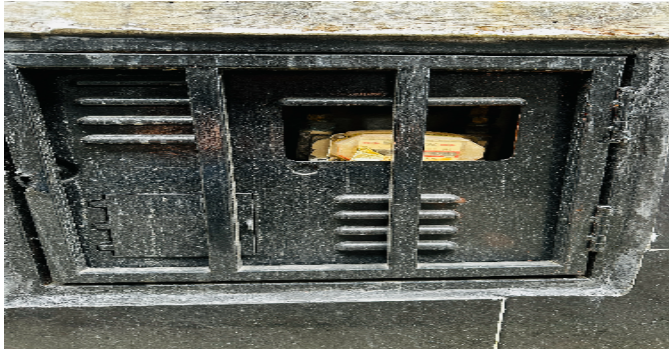
Contador de Gas
