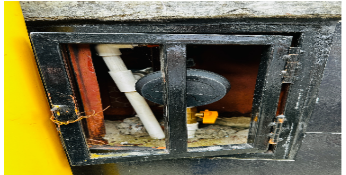
Contador de Agua
