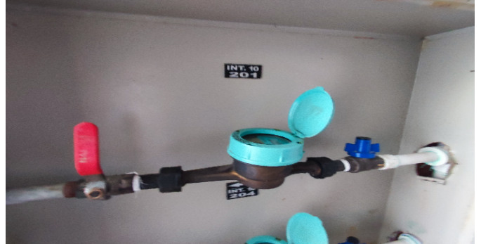
Contador de Agua
