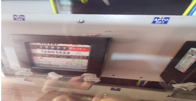
Contador de Energia
