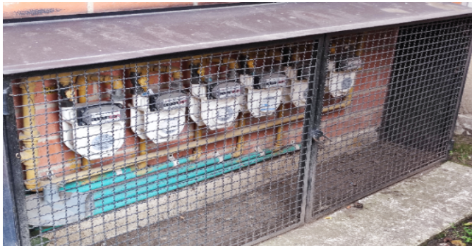
Contador de Gas
