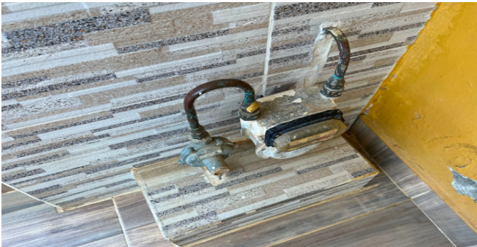
Contador de Gas
