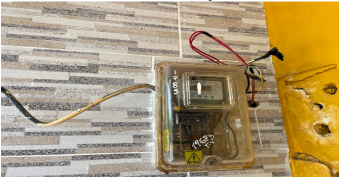
Contador de Energia
