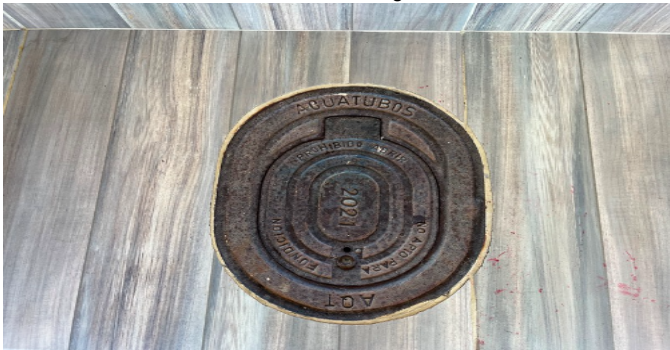
Contador de Agua
