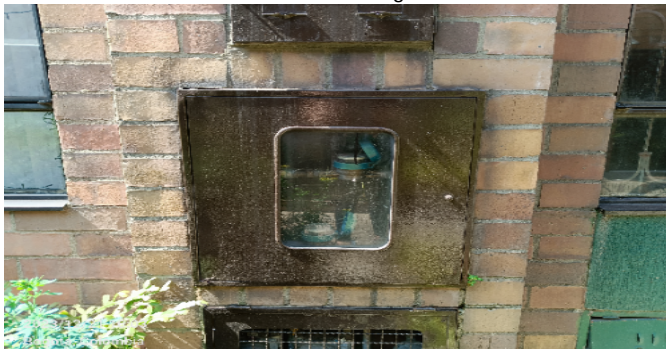
Contador de Agua
