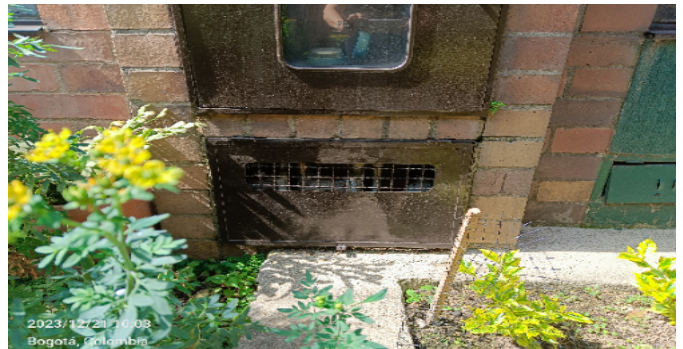
Contador de Gas
