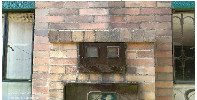
Contador de Energia
