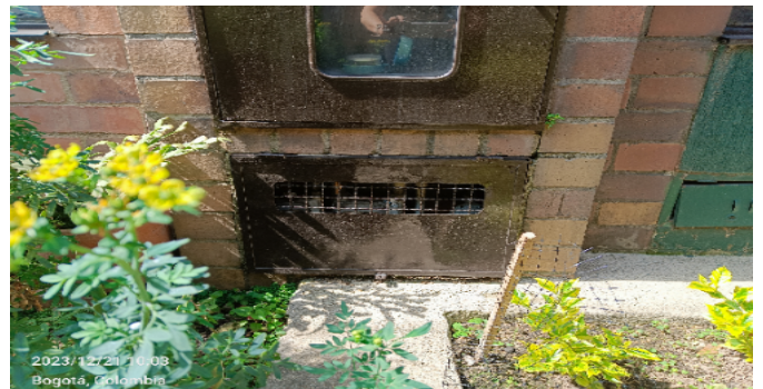
Contador de Gas
