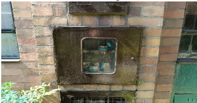
Contador de Agua
