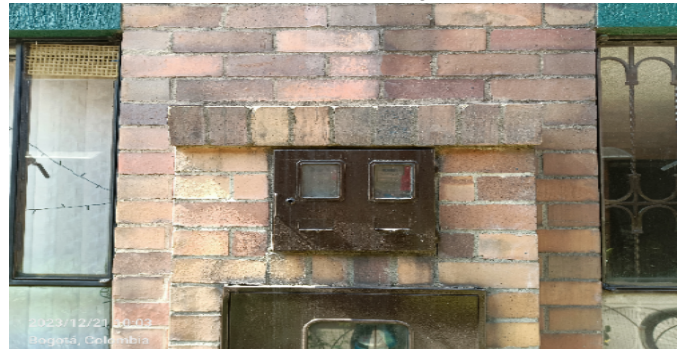
Contador de Energia
