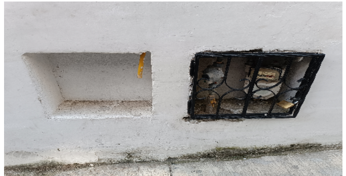
Contador de Gas
