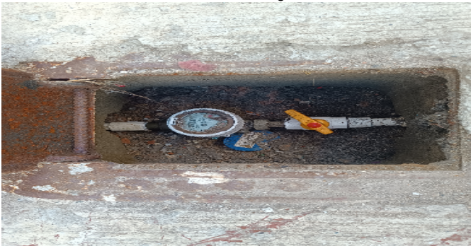
Contador de Agua
