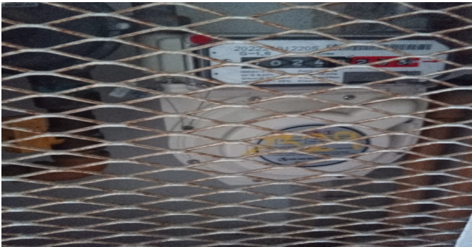
Contador de Gas
