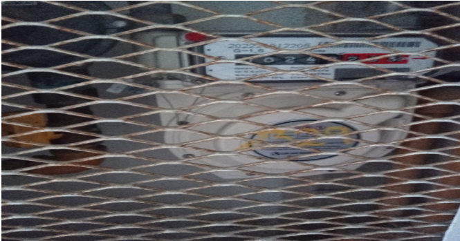
Contador de Gas
