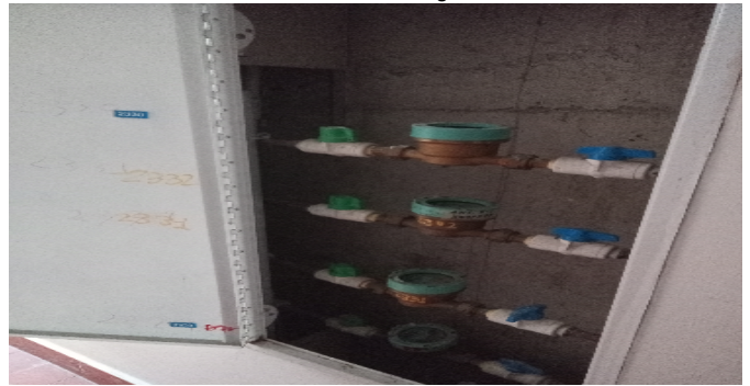
Contador de Agua
