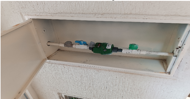
Contador de Agua
