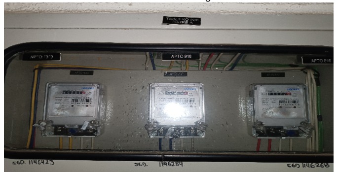
Contador de Energia
