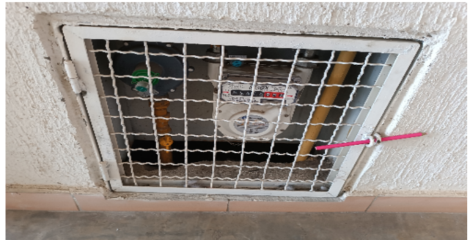
Contador de Gas
