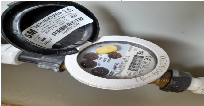
Contador de Agua
