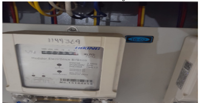
Contador de Energia
