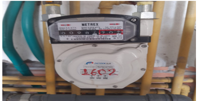
Contador de Gas
