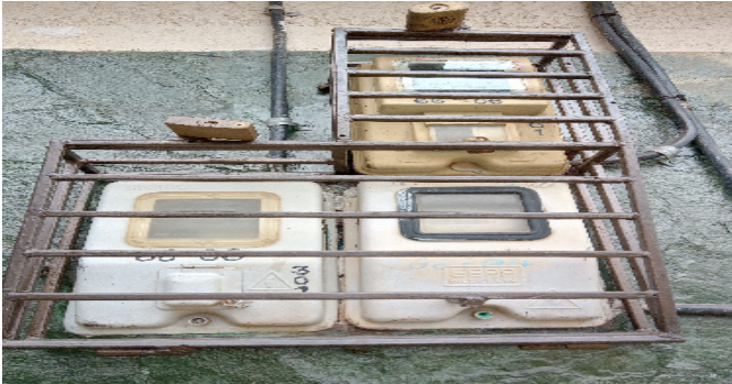
Contador de Energia
