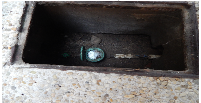
Contador de Agua
