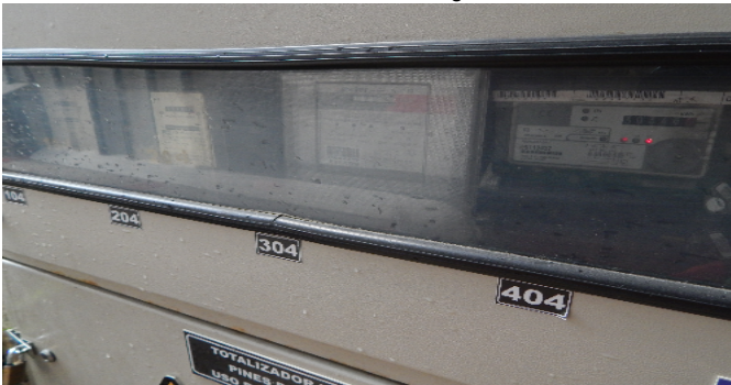
Contador de Energia
