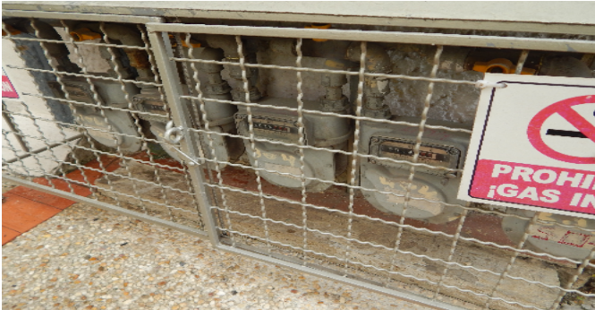
Contador de Gas
