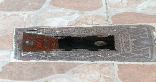
Contador de Agua
