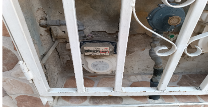
Contador de Gas
