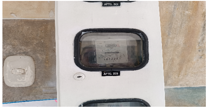
Contador de Energia
