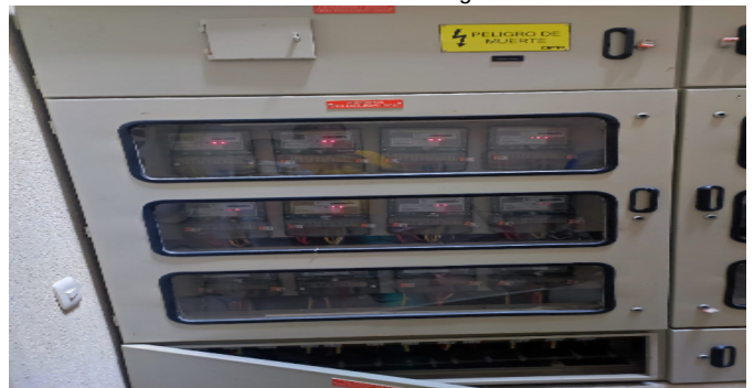
Contador de Energia
