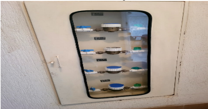
Contador de Agua
