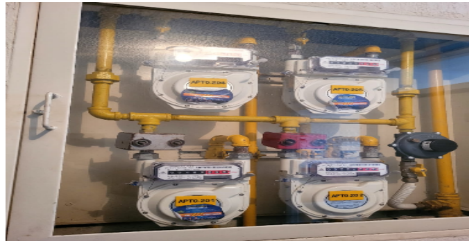
Contador de Gas
