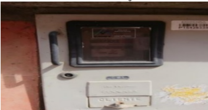
Contador de Energia
