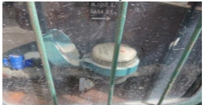
Contador de Agua
