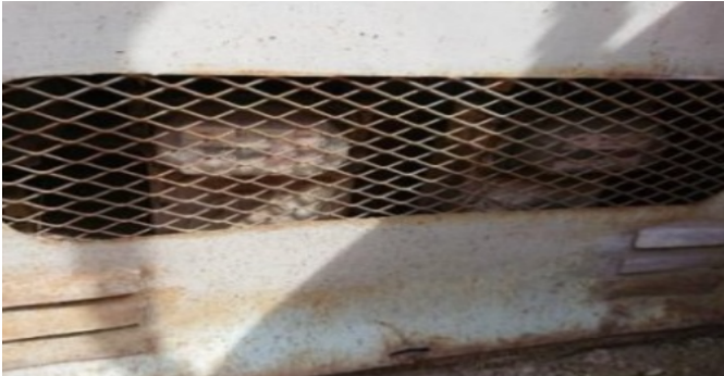
Contador de Gas
