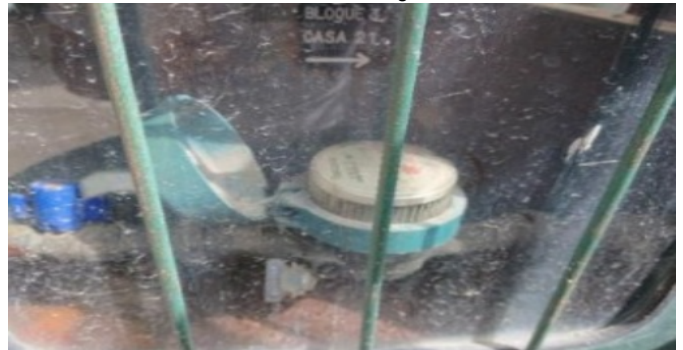
Contador de Agua
