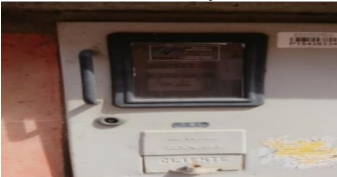
Contador de Energia
