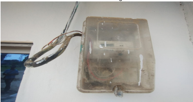
Contador de Energia
