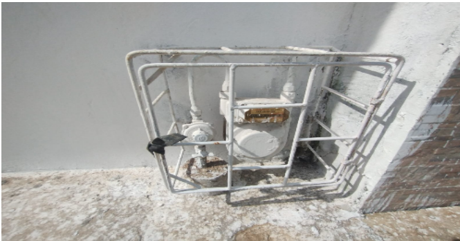
Contador de Gas
