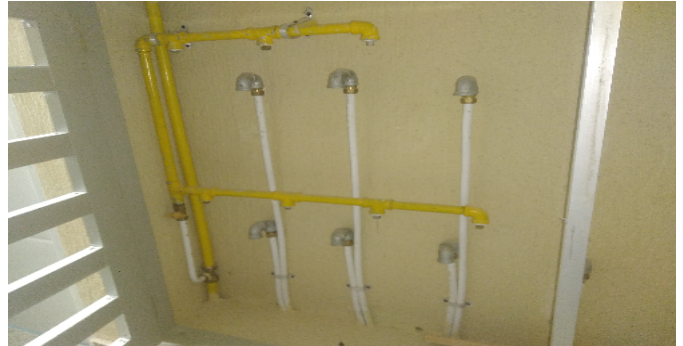
Contador de Gas
