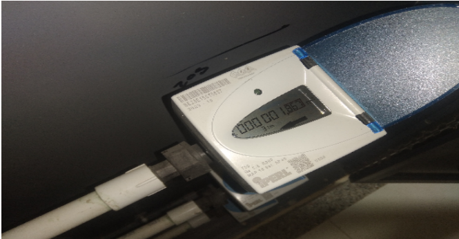
Contador de Agua
