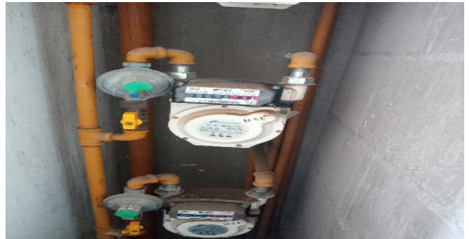
Contador de Gas
