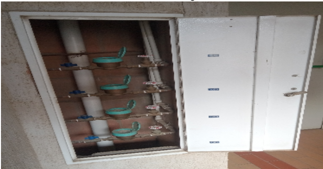
Contador de Agua
