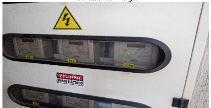
Contador de Energia
