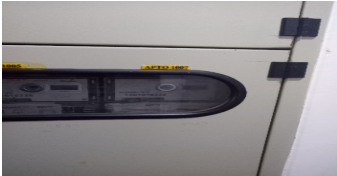
Contador de Energia
