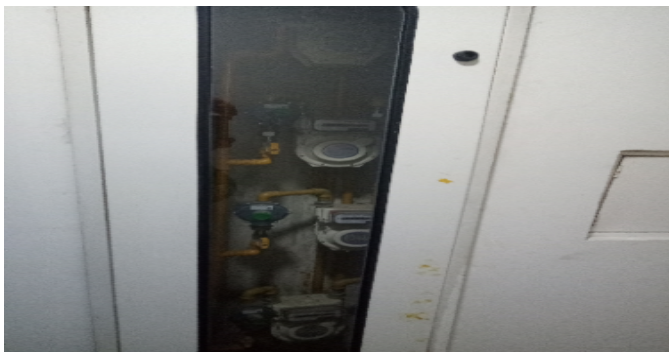
Contador de Gas
