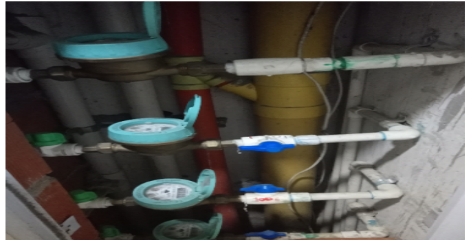
Contador de Agua
