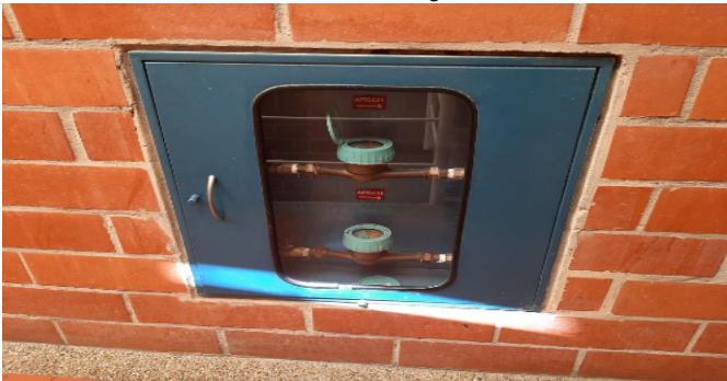
Contador de Agua
