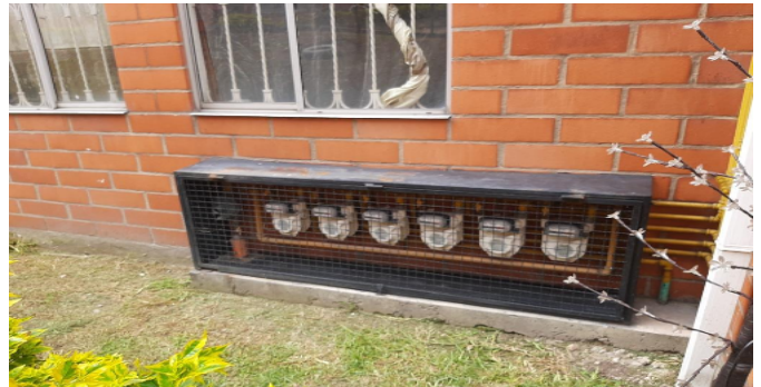
Contador de Gas
