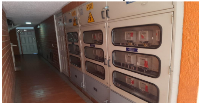
Contador de Energia
