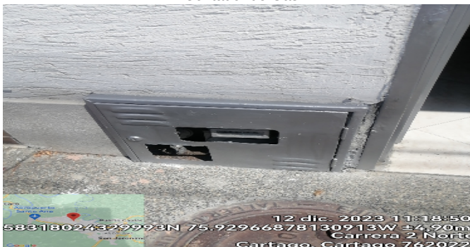
Contador de Gas
