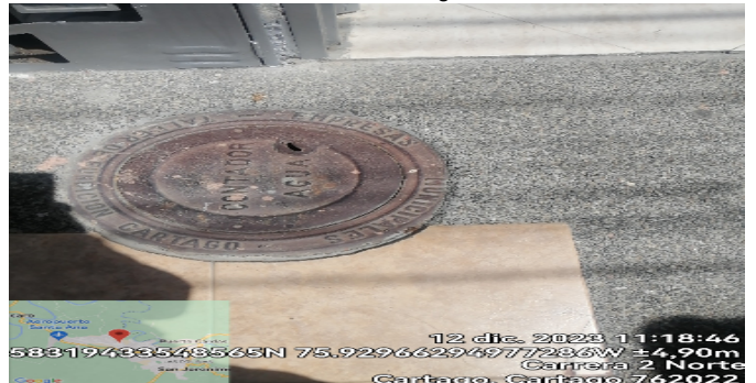
Contador de Agua
