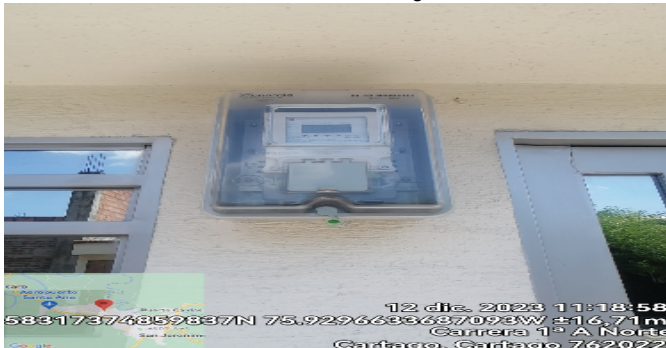
Contador de Energia
