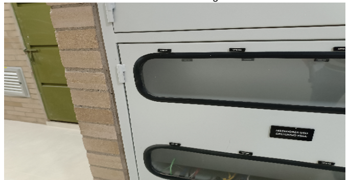
Contador de Energia
