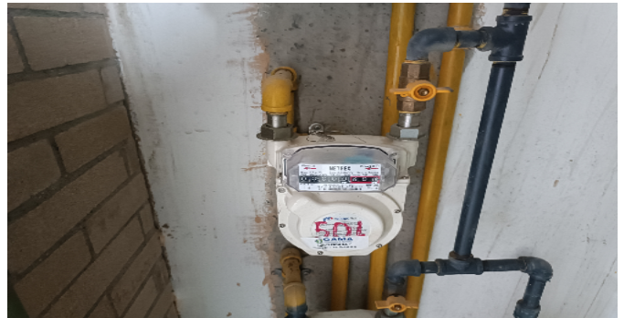
Contador de Gas
