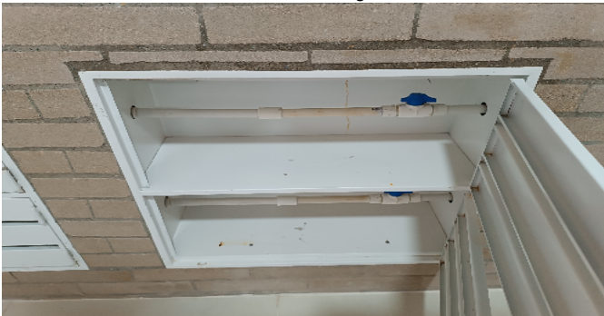
Contador de Agua
