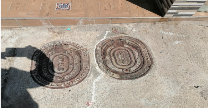
Contador de Agua
