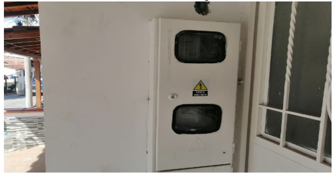
Contador de Energia
