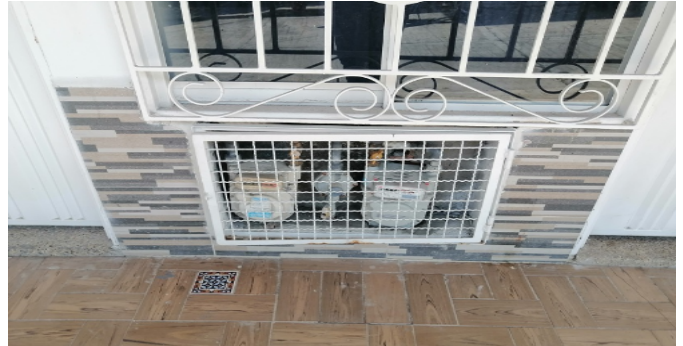
Contador de Gas
