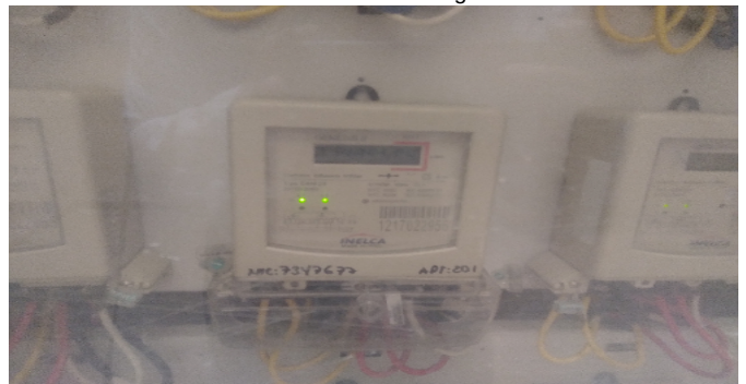
Contador de Energia
