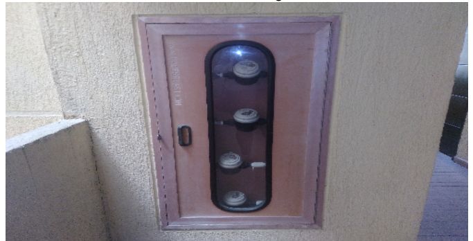
Contador de Agua
