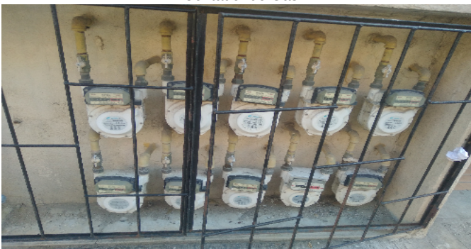
Contador de Gas
