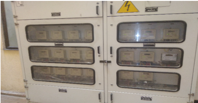
Contador de Energia
