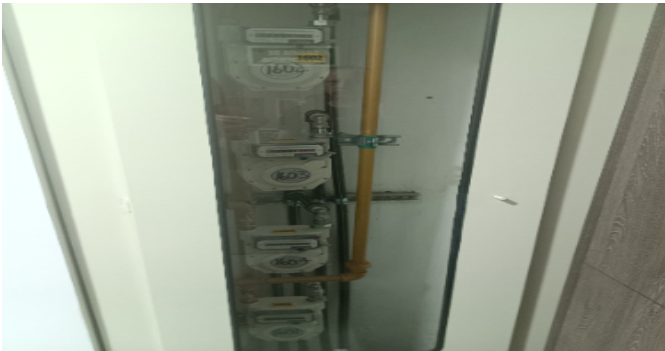
Contador de Gas
