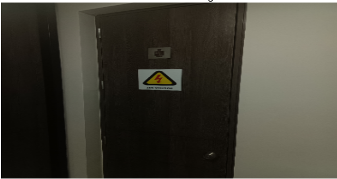
Contador de Energia
