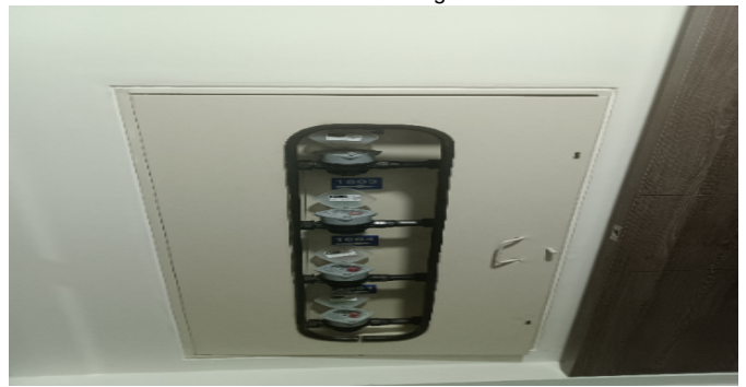
Contador de Agua
