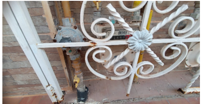
Contador de Gas
