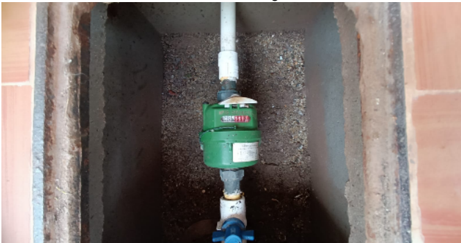
Contador de Agua
