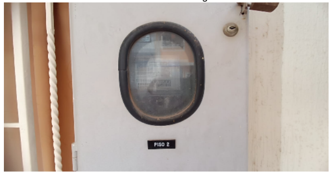
Contador de Energia
