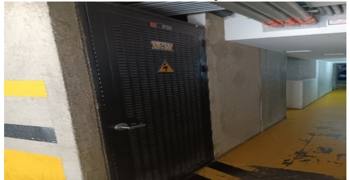
Contador de Energia
