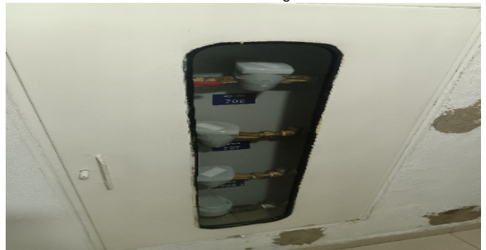
Contador de Agua
