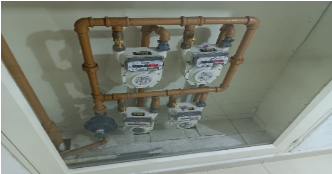
Contador de Gas
