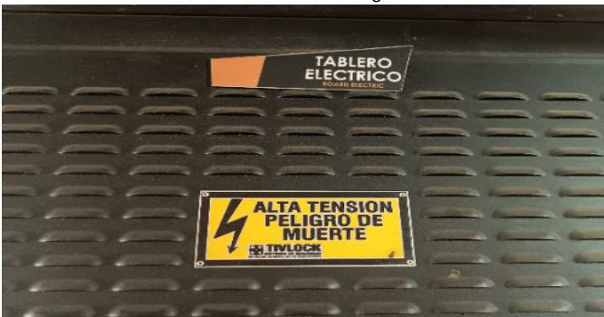
Contador de Energia
