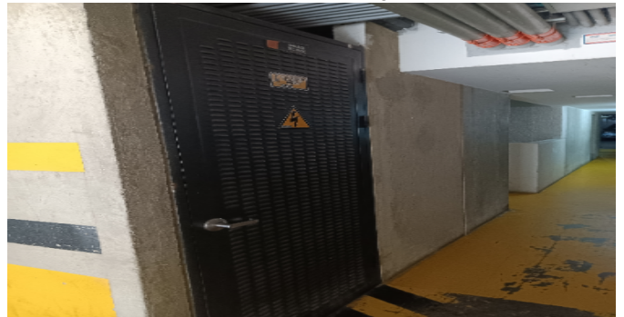
Contador de Energia
