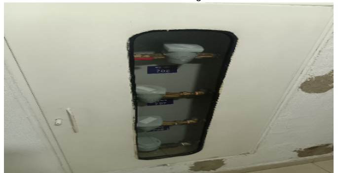
Contador de Agua
