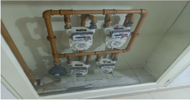
Contador de Gas
