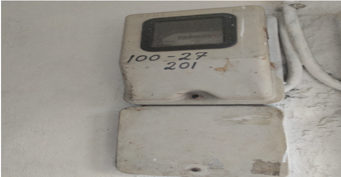
Contador de Energia
