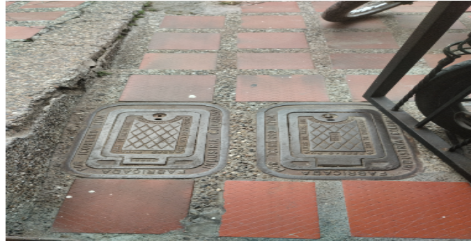
Contador de Agua
