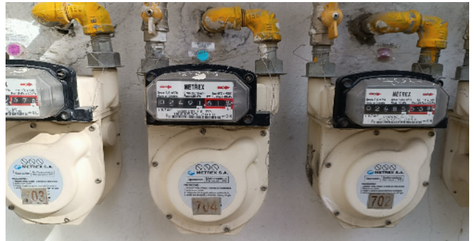
Contador de Gas
