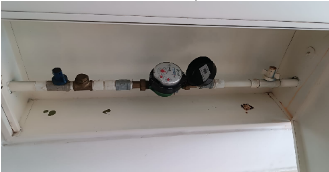
Contador de Agua
