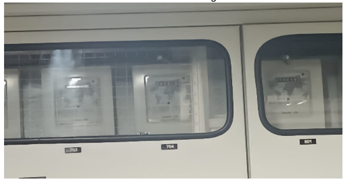
Contador de Energia
