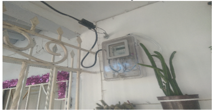
Contador de Energia
