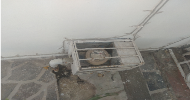
Contador de Agua
