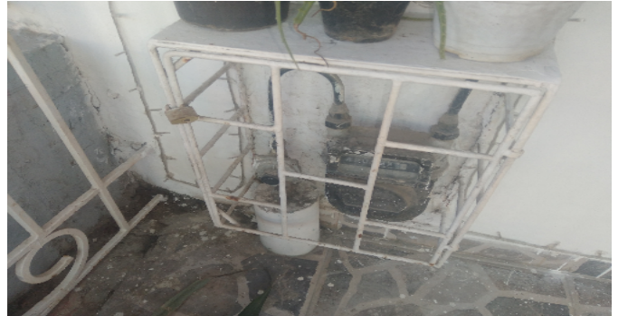
Contador de Gas
