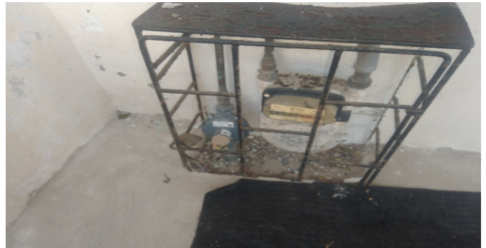
Contador de Gas
