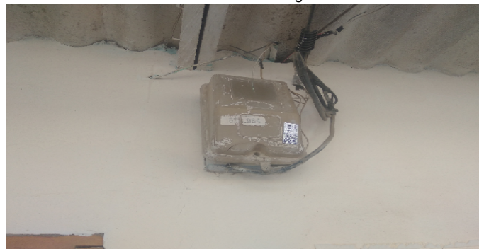
Contador de Energia
