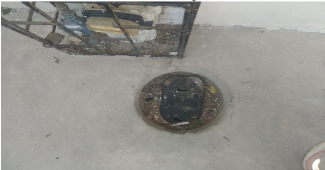
Contador de Agua
