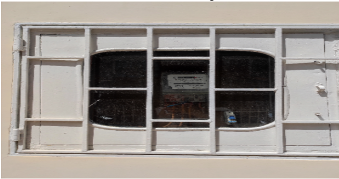
Contador de Energia
