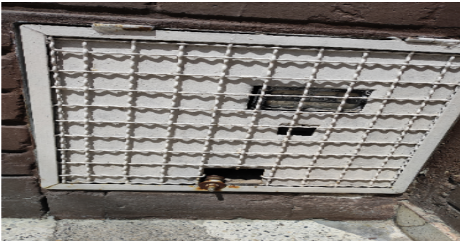
Contador de Gas
