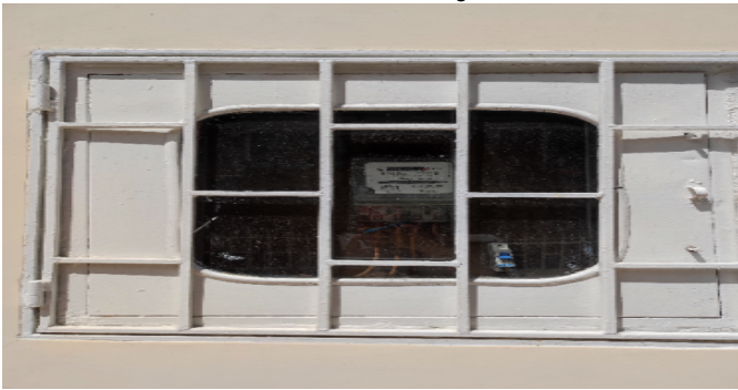
Contador de Energia
