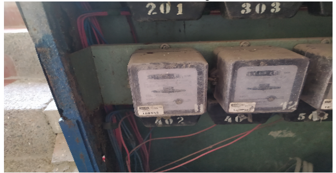
Contador de Energia
