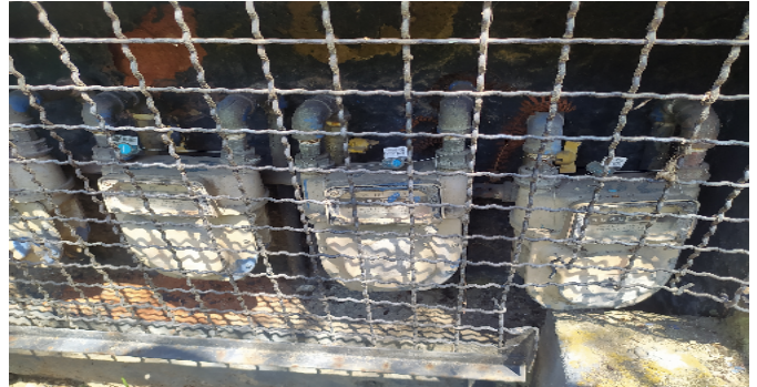
Contador de Gas
