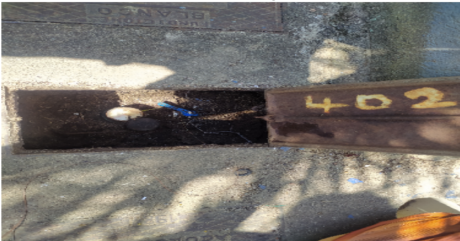
Contador de Agua
