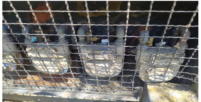
Contador de Gas
