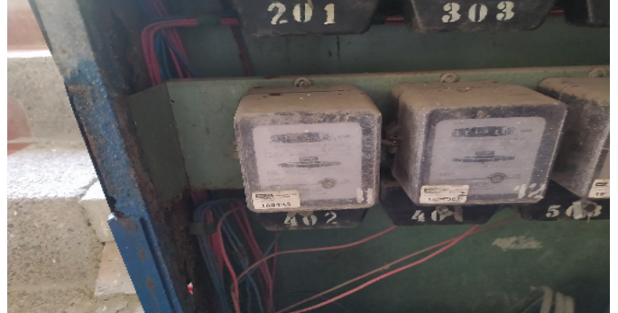
Contador de Energia
