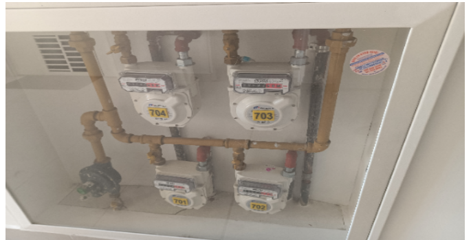
Contador de Gas
