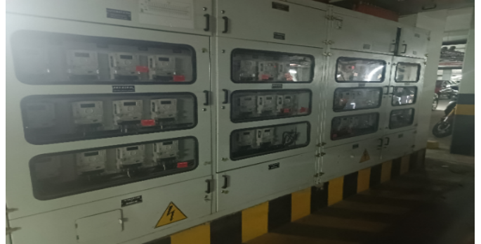
Contador de Energia
