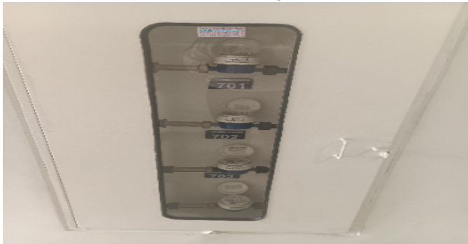
Contador de Agua
