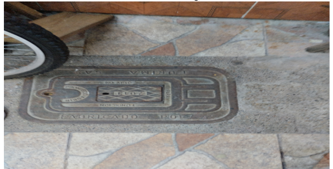
Contador de Agua
