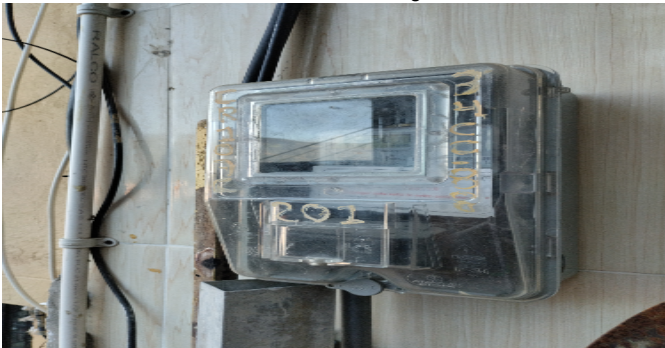
Contador de Energia
