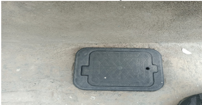
Contador de Agua
