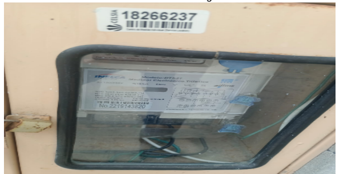
Contador de Energia
