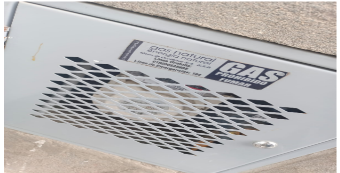
Contador de Gas
