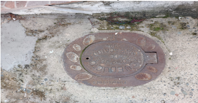
Contador de Agua
