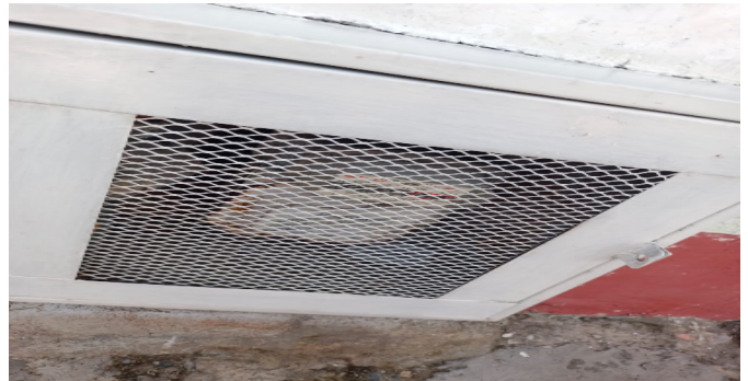
Contador de Gas
