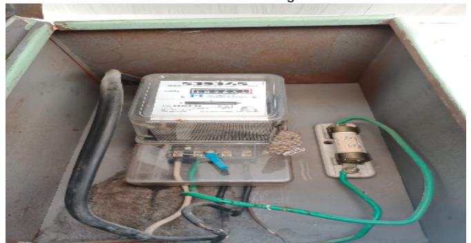
Contador de Energia
