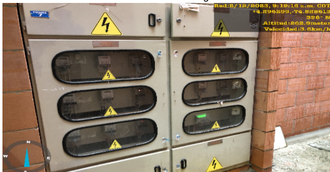
Contador de Energia
