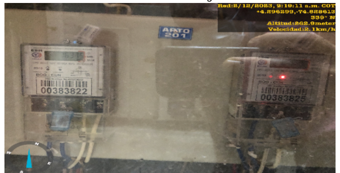
Contador de Energia
