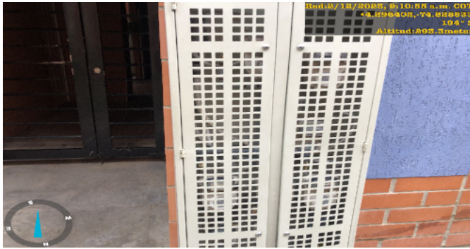
Contador de Gas
