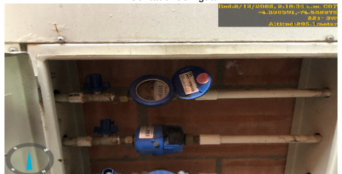
Contador de Agua
