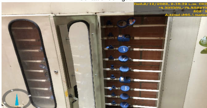
Contador de Agua
