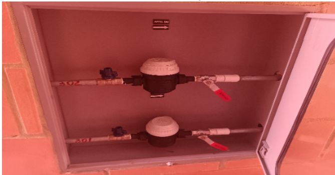
Contador de Agua
