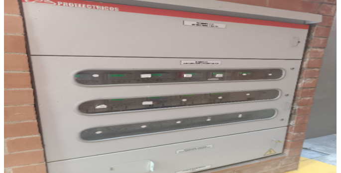
Contador de Energia
