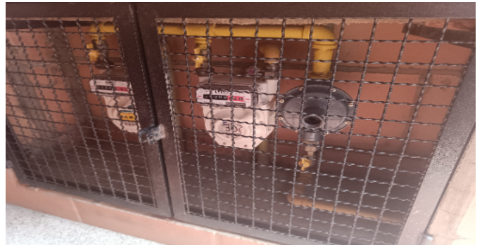
Contador de Gas
