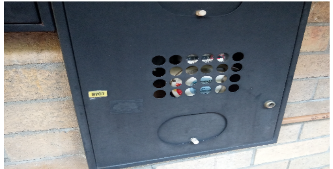
Contador de Gas
