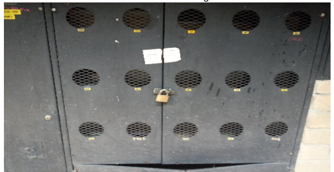
Contador de Energia
