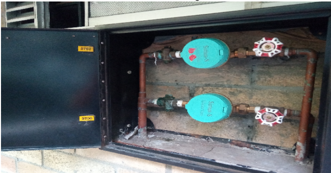
Contador de Agua
