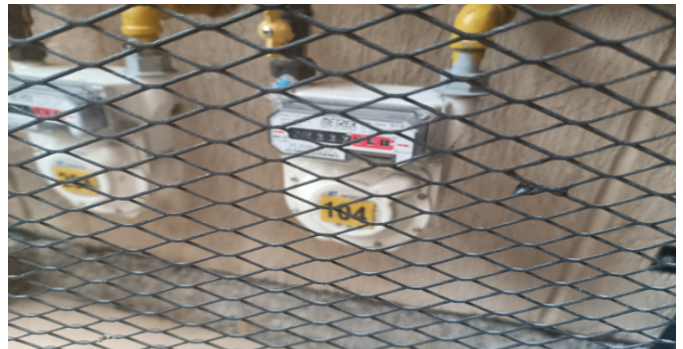
Contador de Gas
