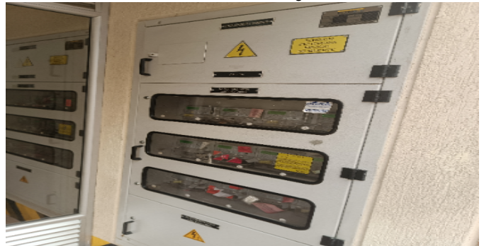
Contador de Energia
