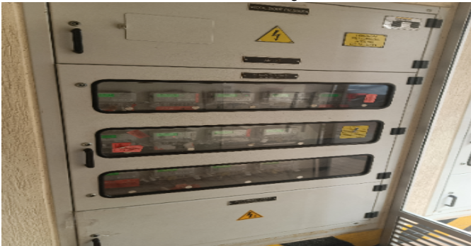
Contador de Energia
