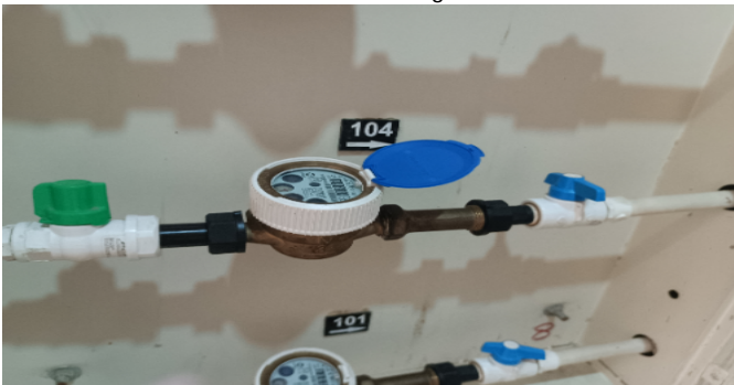
Contador de Agua
