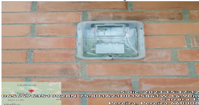
Contador de Energia
