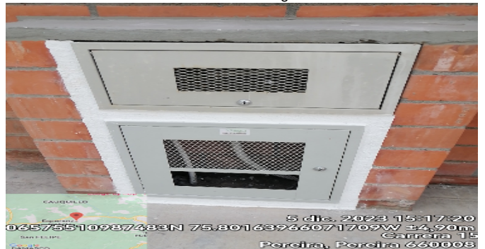
Contador de Agua
