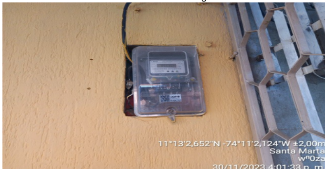
Contador de Energia
